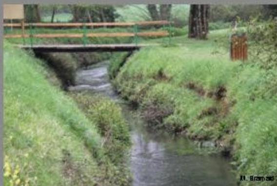
Glissement de berge suite à une incision (érosion progressive)
